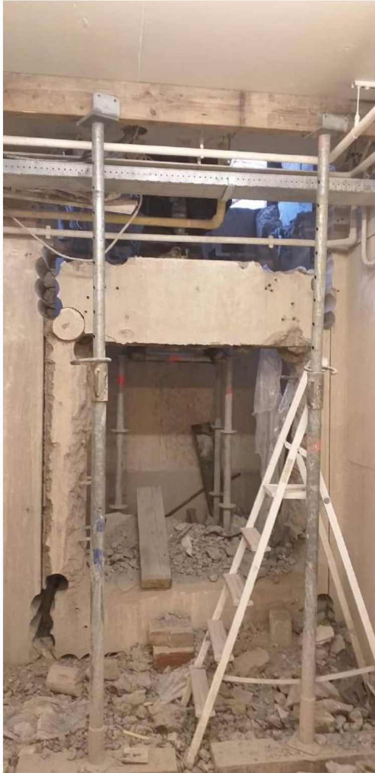
Dit moet eens een liftdeur worden in de kelder.
